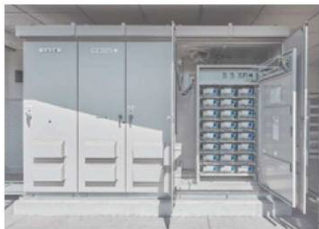
体育館の軒下に屋外キュービクルで設置
