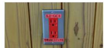
災害時に使用する体育館の非常用コンセント
