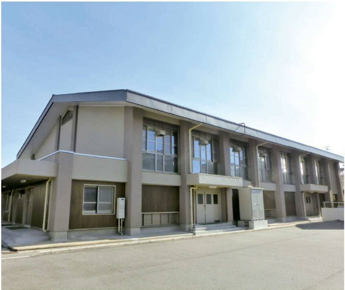
体育館横に屋外キュービクルで設置された蓄電システム
