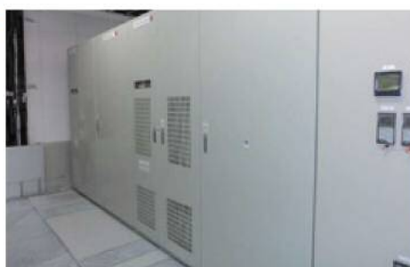
電気室内に蓄電システム2セットを列盤で設置
