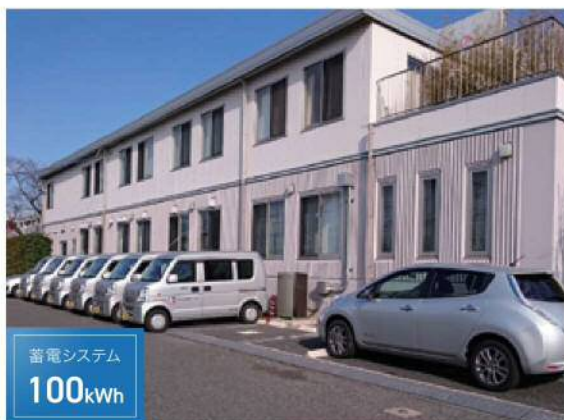
東京都世田谷区 2016年 株式会社京王設備サービス 桜上水総合事務所 様 三相ラインバックΣⅢ 30kVA×1台
