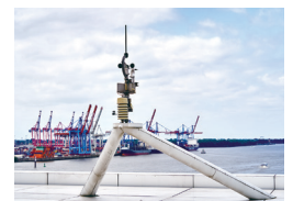
防災監視センサー
